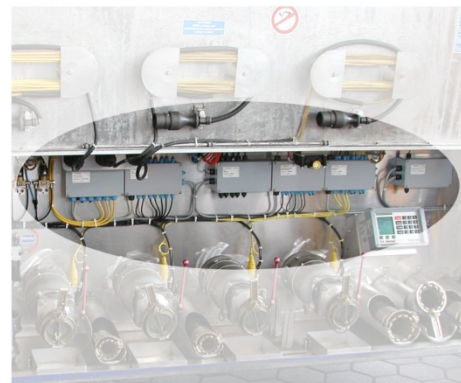
Abb. 1: Beispiel Installation im TKW
